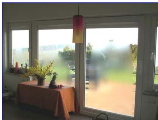
Figuur 20: Condensatie op de beglazing aan de buitenzijde van een lokaal.
