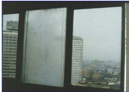
Figuur 19: Condensatie op de spouwzijden van een beglazing.
